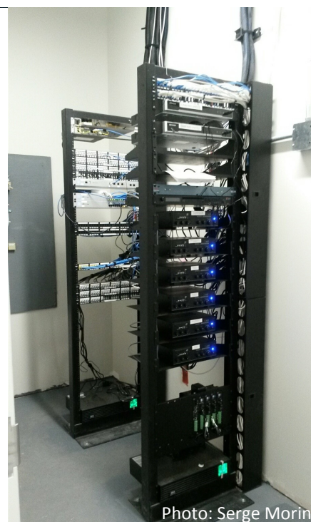
Réseau internet à fibre optique
